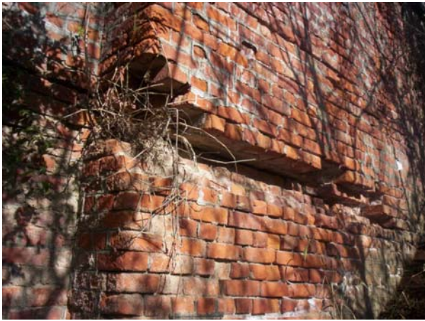
Figura N° 15. Desprendimiento de hiladas en el estribo Norte. Fuente: fotografía de los autores.
