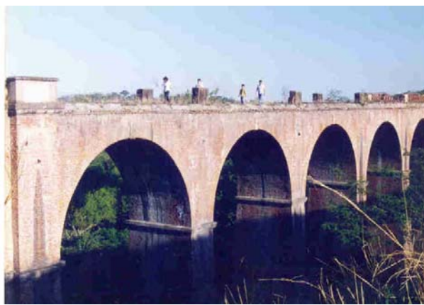
Foto N° 22. Acción del vandalismo. Fuente: fotografía de los autores.
