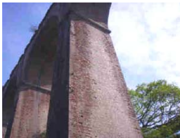
Figura N° 20. Erosión del aladrillo. Fuente: fotografía de los autores.
