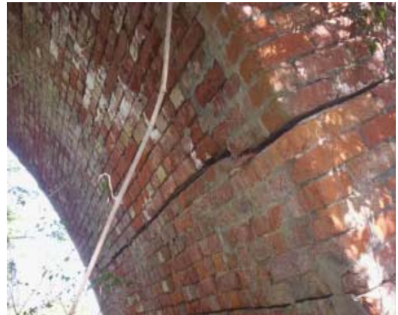
Figura N° 18. Agrietamiento de Arco N° 25. Fuente: fotografía de los autores.
