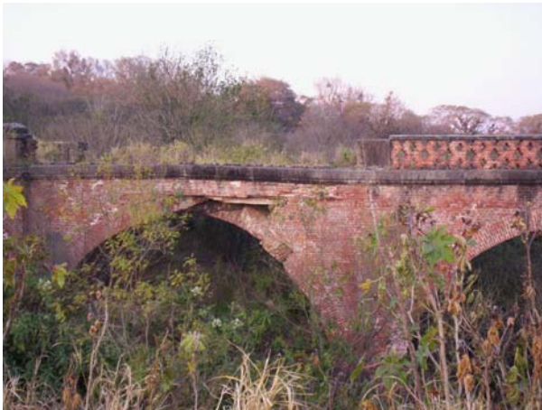
Figura N° 17. Asentamiento diferencial del pilar de la cabecera Norte. Fuente: fotografía de los autores.
