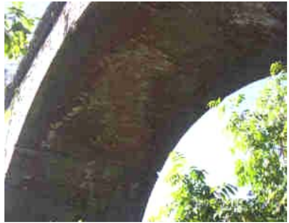
Figura N°16. Agrietamientos en Arco N°1. Fuente: fotografía de los autores.
