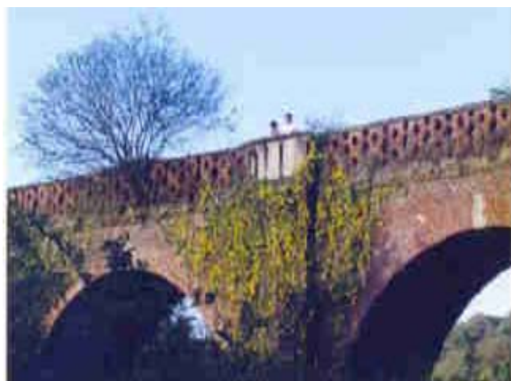
Foto N° 21. Enredaderas y árboles puebla la estructura. Fuente: fotografía
