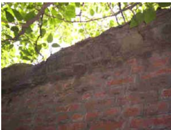
Figura N° 19 .Erosión de las cornisas y ornamentos Fuente: fotografía de los autores.
