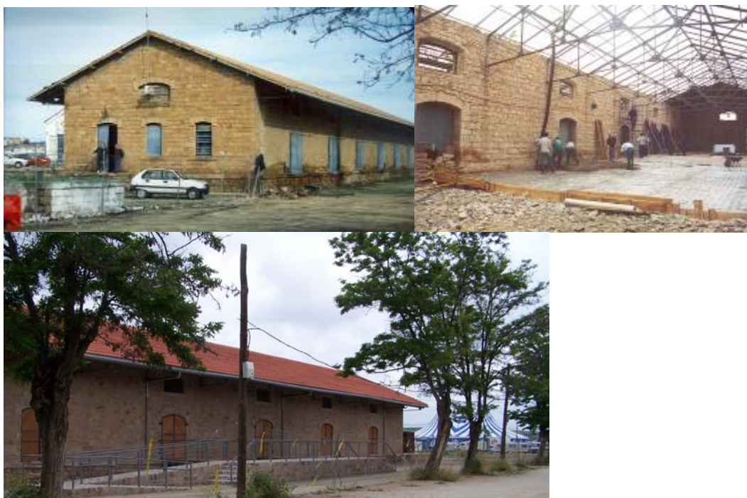
Figura nº9: Proceso de rehabilitación del muelle de carga cubierto cerrado. 1998-2005 (Escuela Taller “Industria y Paisaje” de Linares).
