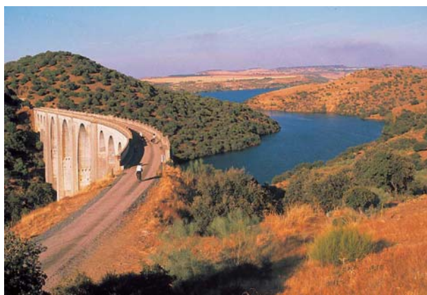
Fig. 1. El Viaducto del Azután vuela sobre el río Tajo en la Vía Verde de La Jara. Foto: Fundación del los Ferrocarriles Españoles
