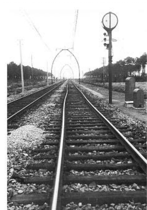
Fig. 5. Estado de la vía en Las Landas después de la circulación a 331 km/h Fuente: La vie du rail
