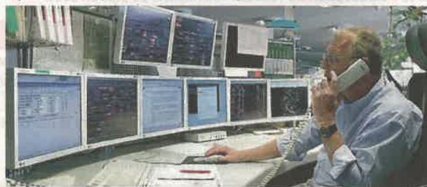
Centre de gestion des circulations ferroviaires en Allemagne.
